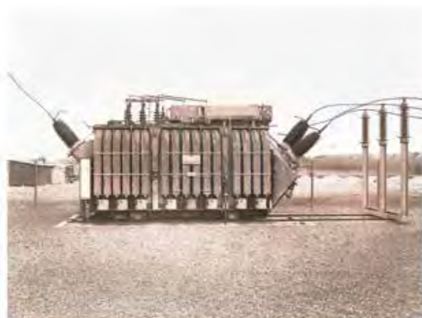
208 BERND (1931-2007) E HILLA BECHER (1934-2015) Transformator, Bous, Saarland 1970 Stampa alla gelatina ai sali d'argento. 30,00 x 39,50 cm Firmata da entrambi gli artisti al verso, timbro con firma Galleria Il Tritone, Biella. Tratto dal portofolio 'Industriebauten'. Transformator, Bous, Saarland 1970 Gelatin silver print 11.81 x 15.55 in. Signed by both artists on the reverse, stamp with signature Galleria Il Tritone, Biella. Taken from the 'Industriebauten' portfolio. Provenienza/Provenance Galleria Sperone, Torino. Galleria d'Arte Il Tritone, Biella. Collezione privata, Biella. € 4.000 - 7.000
